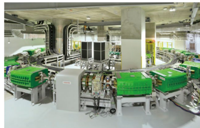
図 7-7 重粒子線治療用加速器（シンクロトロン）
