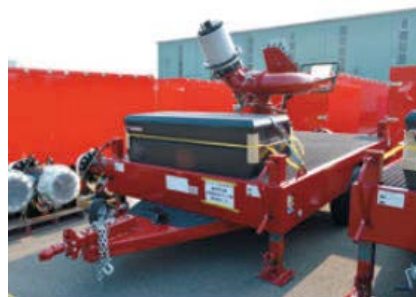
屋外放水設備
