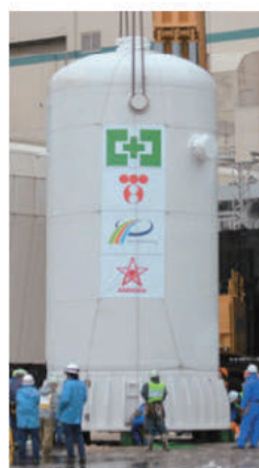
フィルタベント設備
