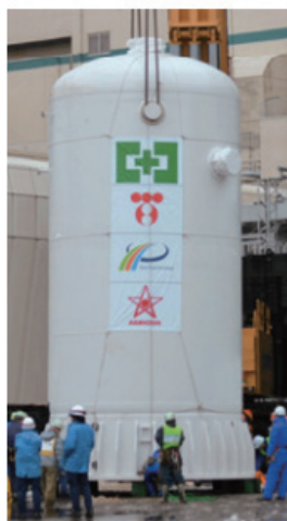
フィルタベント設備
