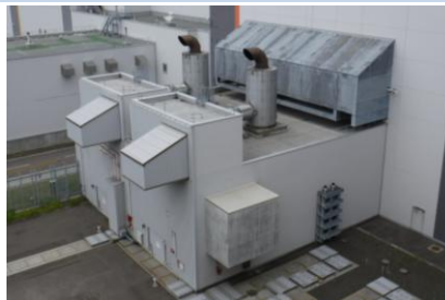
3号R/B給気フード防護鋼板
