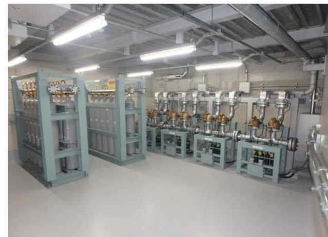
ハロゲン化物消火設備 ボンベ庫
