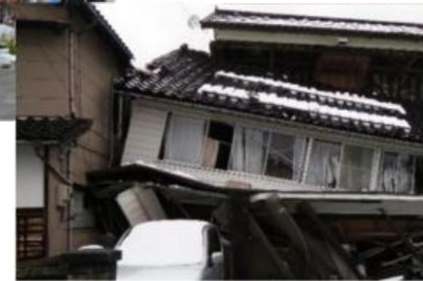
木造建築物の倒壊状況（穴水町）
