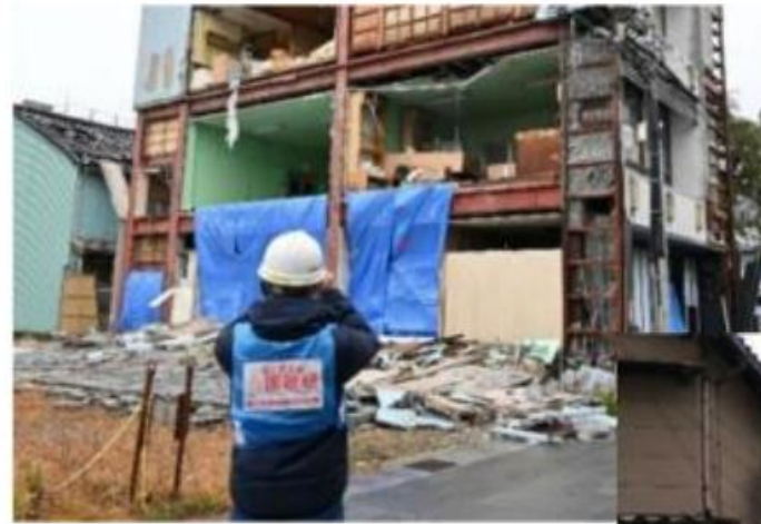
建築物の損壊状況（七尾市）
