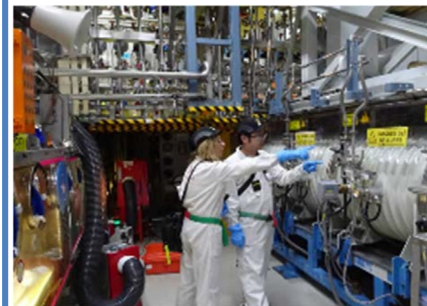
設備の稼働状況を確認している様子 (当社)
