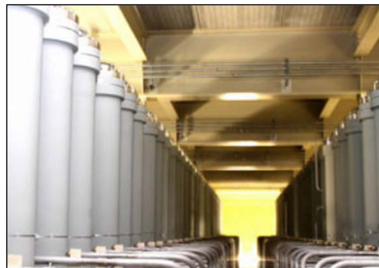
複数の遠心分離機が連結して置かれているカスケード室
