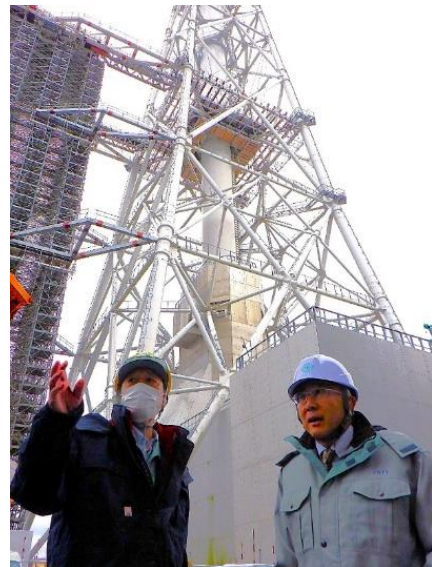
再処理施設の主排気筒
