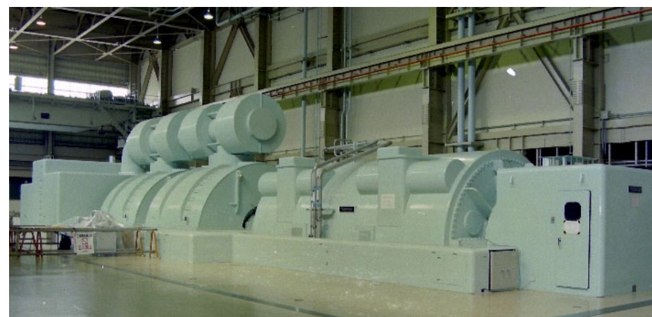
タービン発電機
