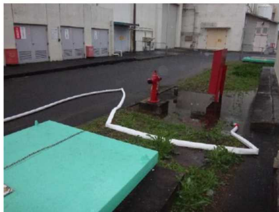
消火用ホース
