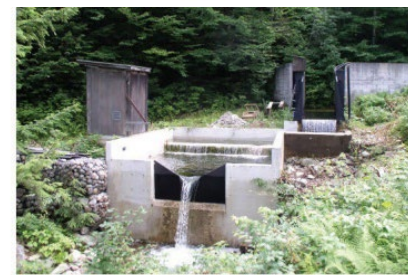
流量観測の設備
