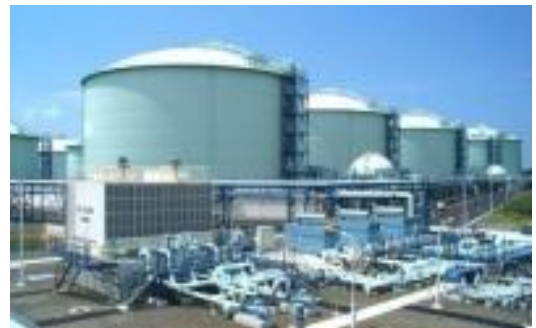
＜福島基地（長崎県）（LPガス）＞
