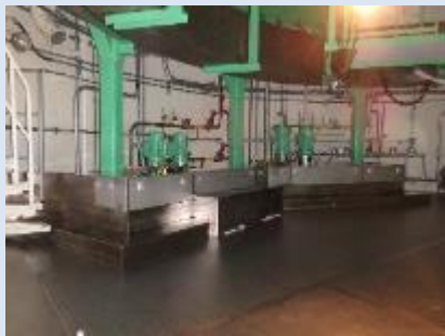
柏崎刈羽7号機のコリウム防御堰での耐熱材導入
