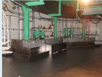
導入された コリウムシールド
