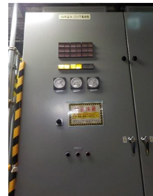
直流125V電源盤
