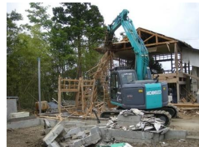
解体した被災家屋の基礎
