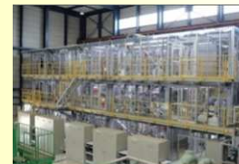
連続水素製造試験装置
