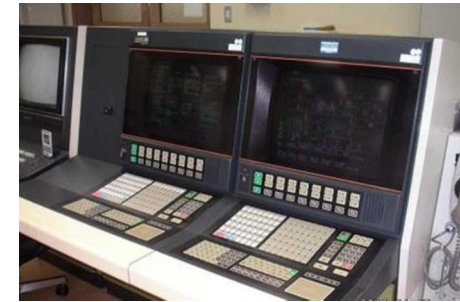
高経年化対策 JRR-3運転制御用プロセス計算機の更新 (原子力科学研究所)
