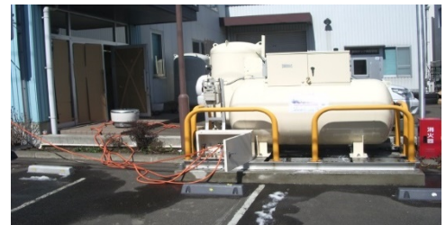
<災害対応型LPガスタンクの活用例>
