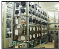
グローブボックス設備
