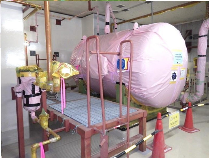
(復水浄化系逆洗用空気貯槽)
