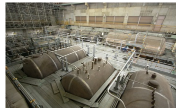
老朽化ナトリウムタンクの解体撤去 (大洗研究開発センター)
