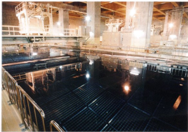
燃料貯蔵プール
