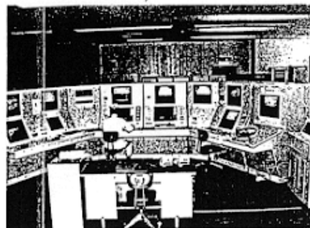
第二アスファルト固化体貯蔵施設・制御室
