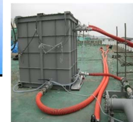
海水循環型浄化装置
