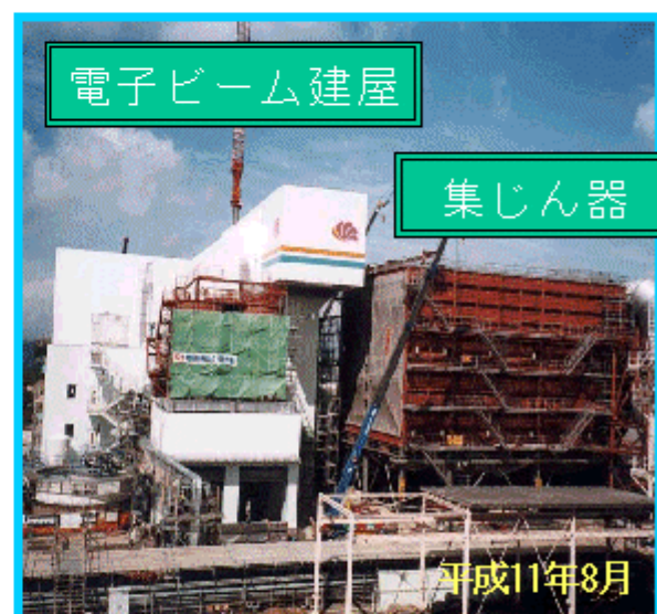
中部電力西名古屋発電所
