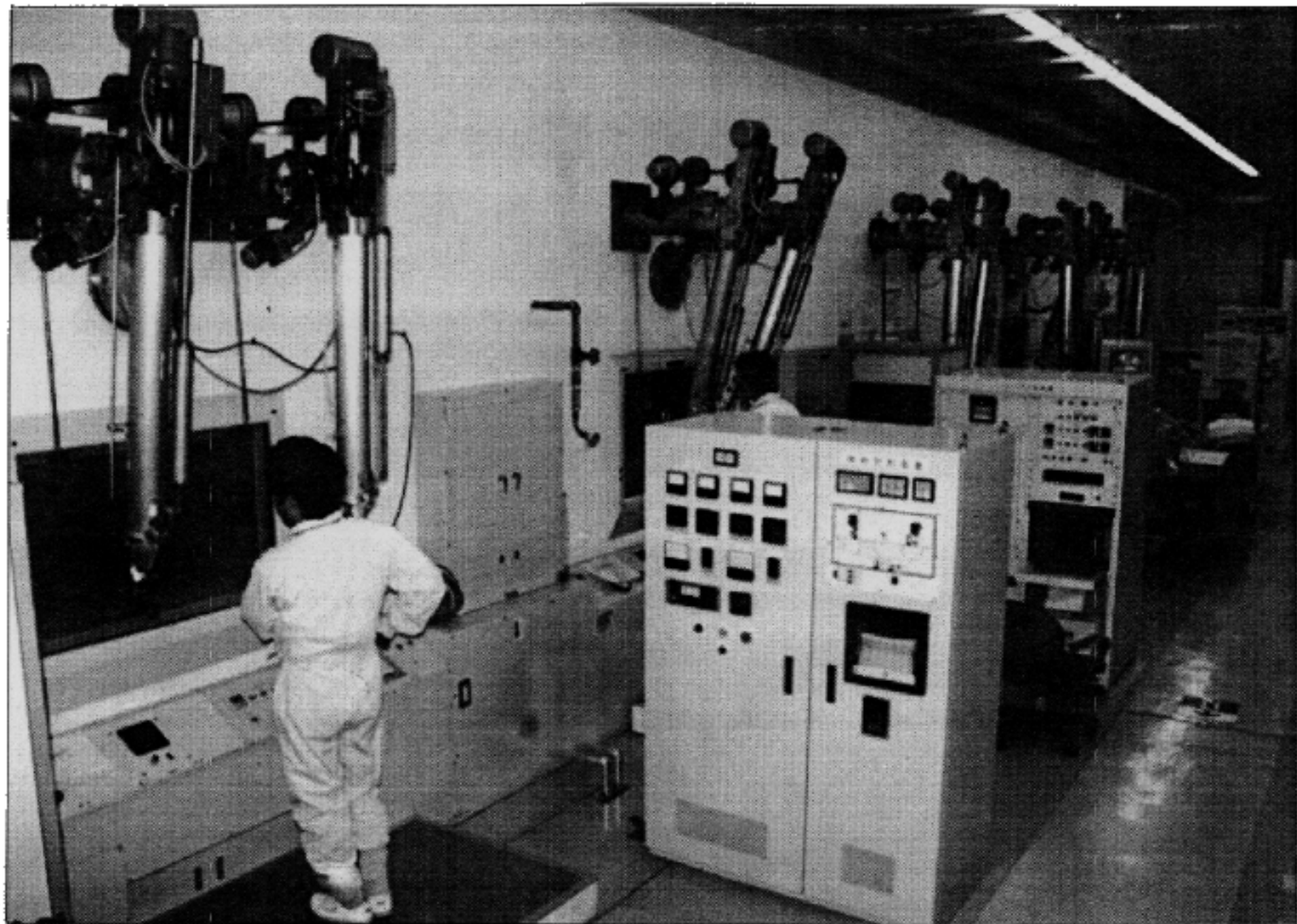
MA含有燃料作製のための遠隔操作制御ライン
