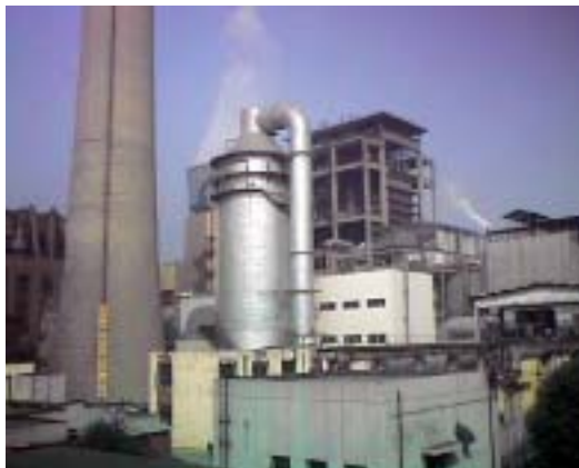
写真 8.8.2 中国の成都にある電子線法排煙浄化装置の全景
