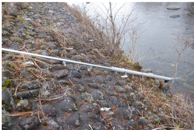
センサー設置状況(大倉川)
