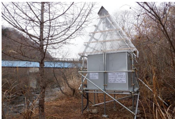
観測装置本体設置状況(大倉川)
