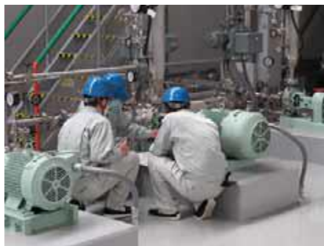
設備の保守点検作業
