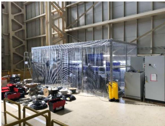
コントロールルーム設置状況
