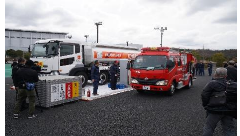
<災害時専用臨時設置給油設備>
