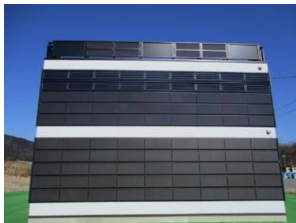
<壁面設置太陽光発電>
