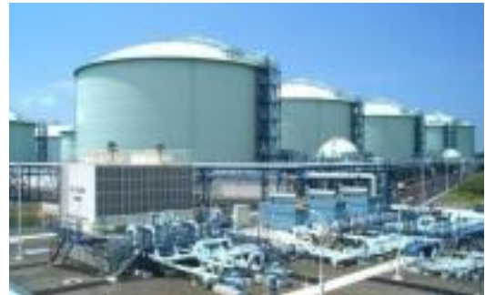
<福島基地（長崎県）（LPガス）>
