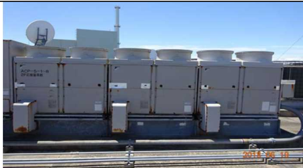
室外機ユニット
