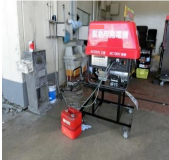
<平成30年北海道胆振東部地震の際に自家発電設備を稼働させて給油を続けたSS>
