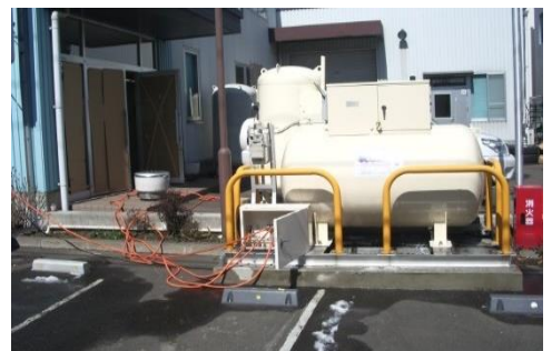
<災害対応型LPガスタンクの活用例>
