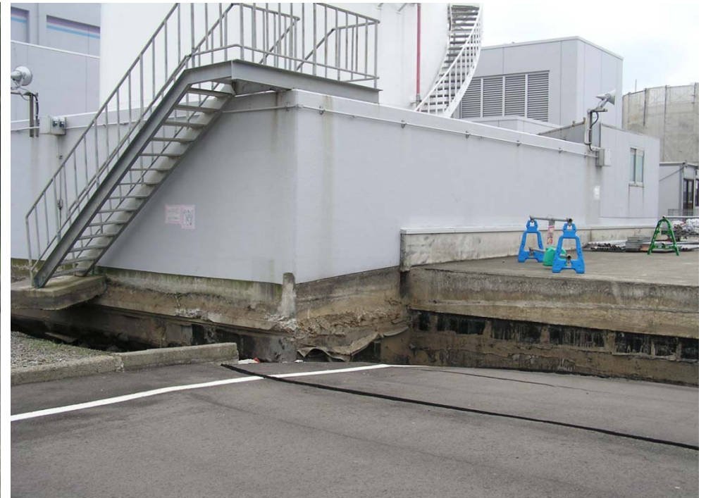
[埋戻し土の沈下]
