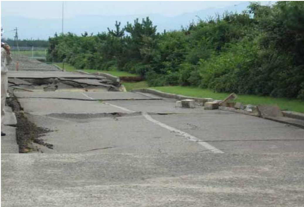
[液状化により沈下]
