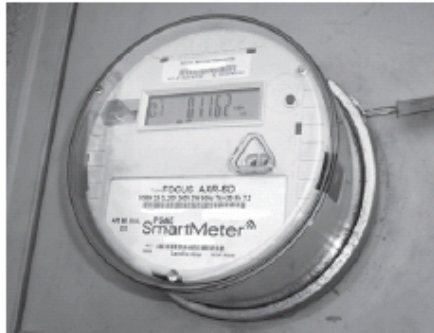
(a) 電力メーター
