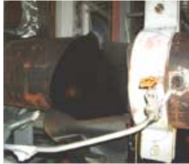
図1-1-1 復水配管破口部の状況
